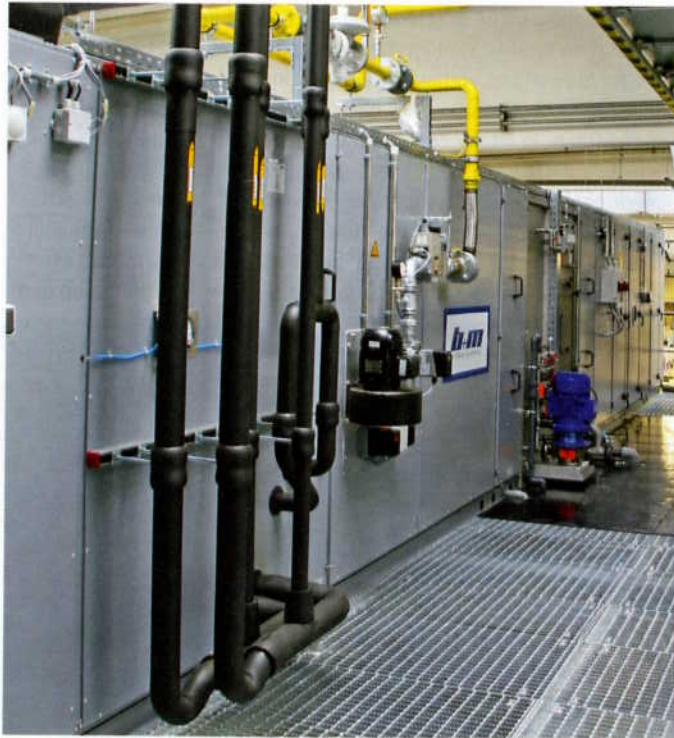
Die vollklimatisierte Zuluftanlage wird über die integrierte „b+mAir“-Energiesparsoftware gesteuert.
