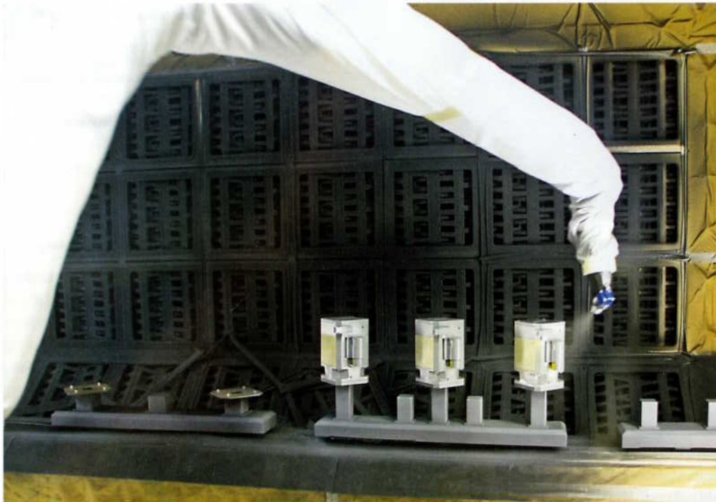
In der Roboterlackierkabine sind Trockenfilter zur Lacknebelabscheidung integriert.
